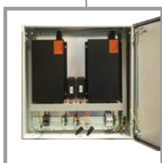
Panel indukcyjny, 2-Kanałowy.
